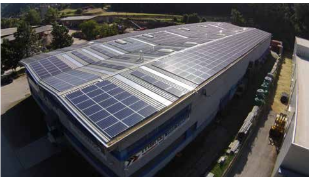
Schweiz, Mezzovico, 265 kWp
